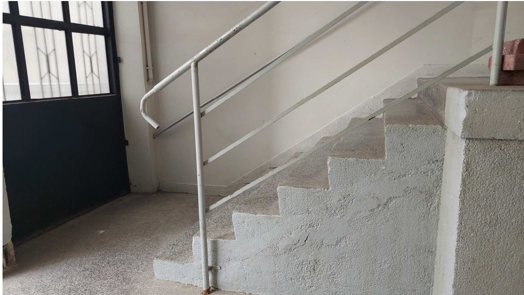
Fot. 6. Schody z rampy od strony północnej, widoczna balustrada stalowa wzdłuż biegu schodowego, widoczne wyjście z prześwitu bramnego w stronę ulicy Hankiewicza
